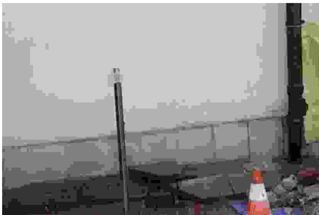
Fotografia 4: Zdjęcie przedstawia przykładowe zarysowanie poziome przy narożniku budynku Świadczące o nierównomiernym osiadaniu budynku.
