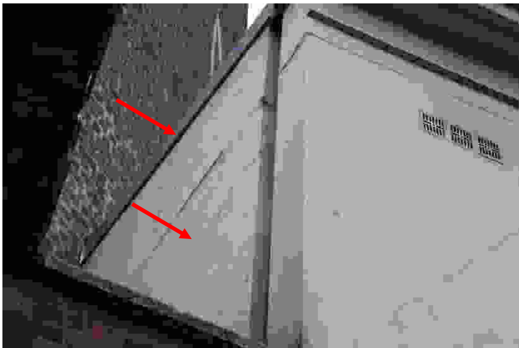
Fotografia 19: Fotografia przedstawia uszkodzenia ścian zewnętrznych budynku nr. 5 od strony wschodniej ściany baszty Senatorskiej. Istniejące uszkodzenia wynikają z oddziaływań klimatycznych takich jak śnieg i woda opadowa. Brak skutecznego okapnika w poziomie dachu.
