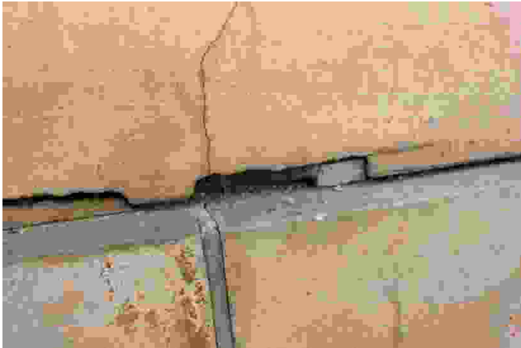
Fotografia 17: Fotografia przedstawia uszkodzenie ściany nad cokołem przy ziemnym.
