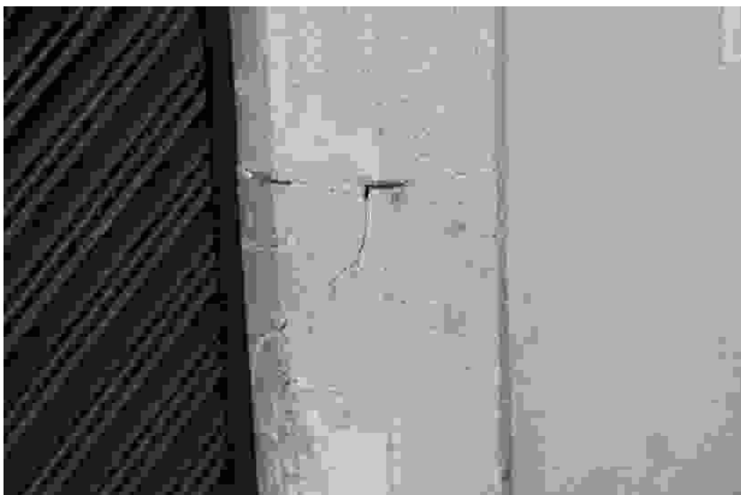
Fotografia 6: Zdjęcie przedstawia uszkodzenie elementu kamiennego przy drzwiach wejściowych do ogólnodostępnych toalet.
