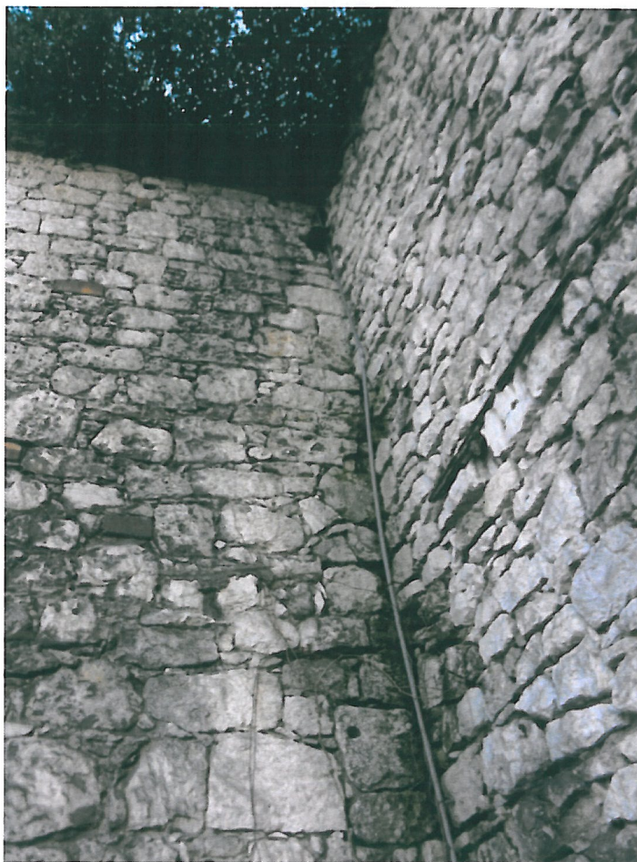
Fot.13 Zawilgocenie muru w sąsiedztwie rzygacza stanowiącego element odwodnienia dachu baszty Szlacheckiej.
