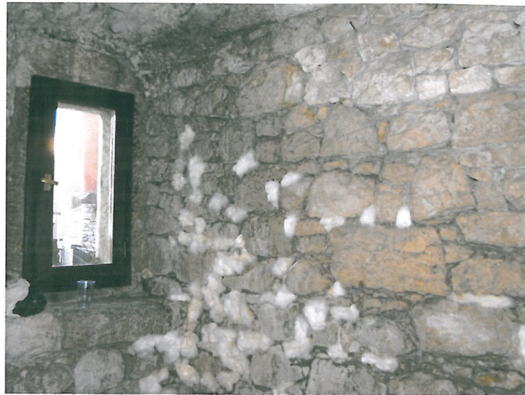
Fot.14 Zawilgocenie wewnętrzne muru baszty Panińskiej wraz z widocznym rozwiązaniem prowizorycznym powierzchniowego pochłaniania wilgoci.
