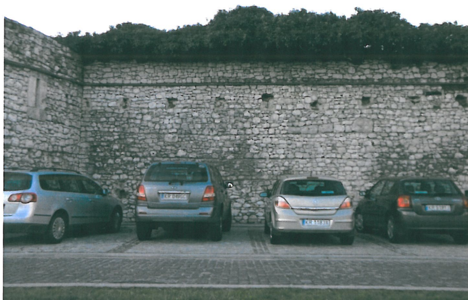
Fot.17 Ubytki w murze, jako pozostałości gniazd pod belki konstrukcyjne.
