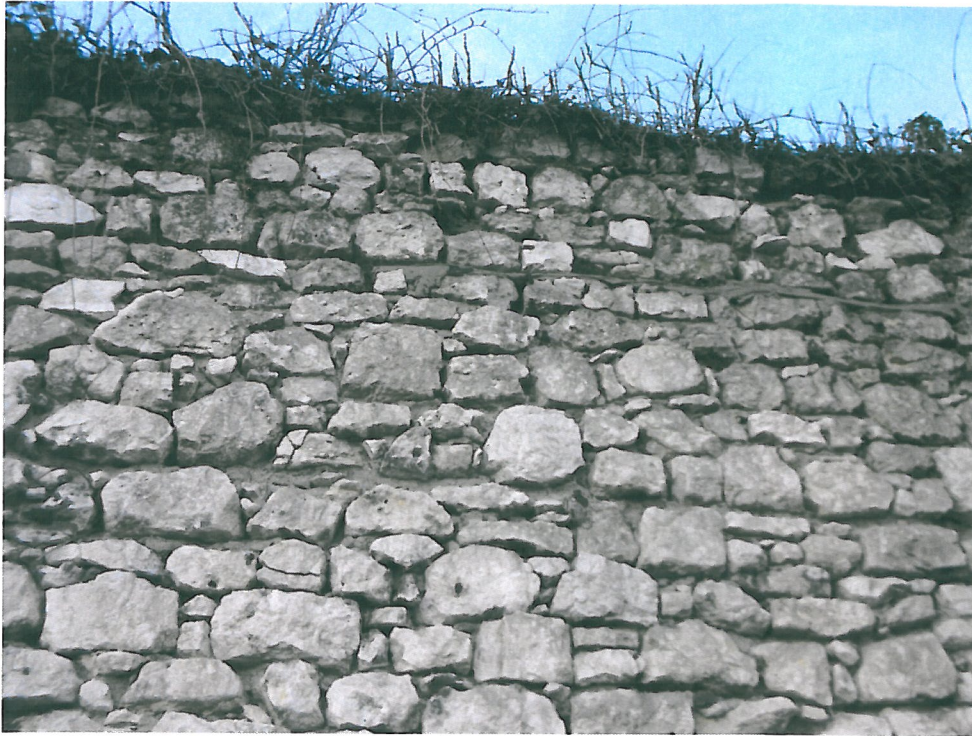
Fot.11 Ubytki spoiwa w górnym paśmie muru.
