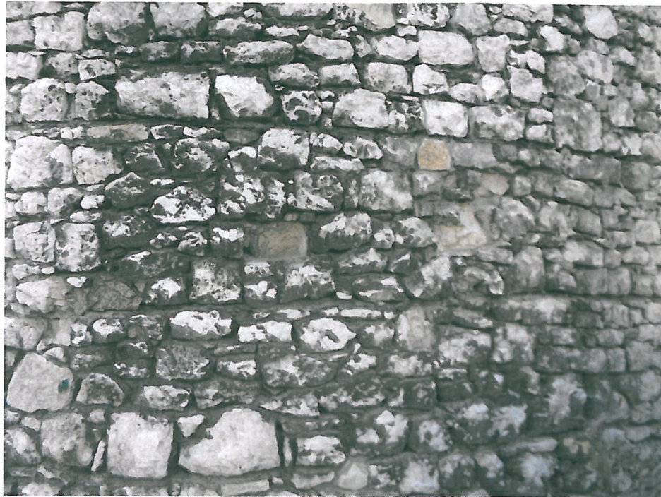
Fot.8 Lokalne ubytki ciosów wapiennych.
