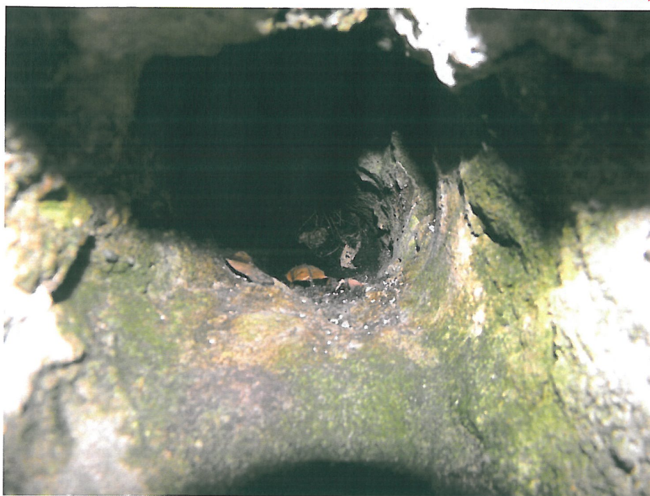
Fot.23 Suchy kanał odwadniającaj - zapewne niedrożny.
