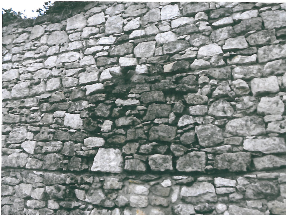
Fot.12 Zawilgocenie muru w obrębie usytuowania rzygacza przy koronie muru.
