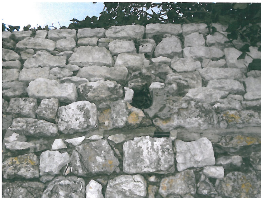
Fot.6 Kanał odprowadzający wodę z korytka
