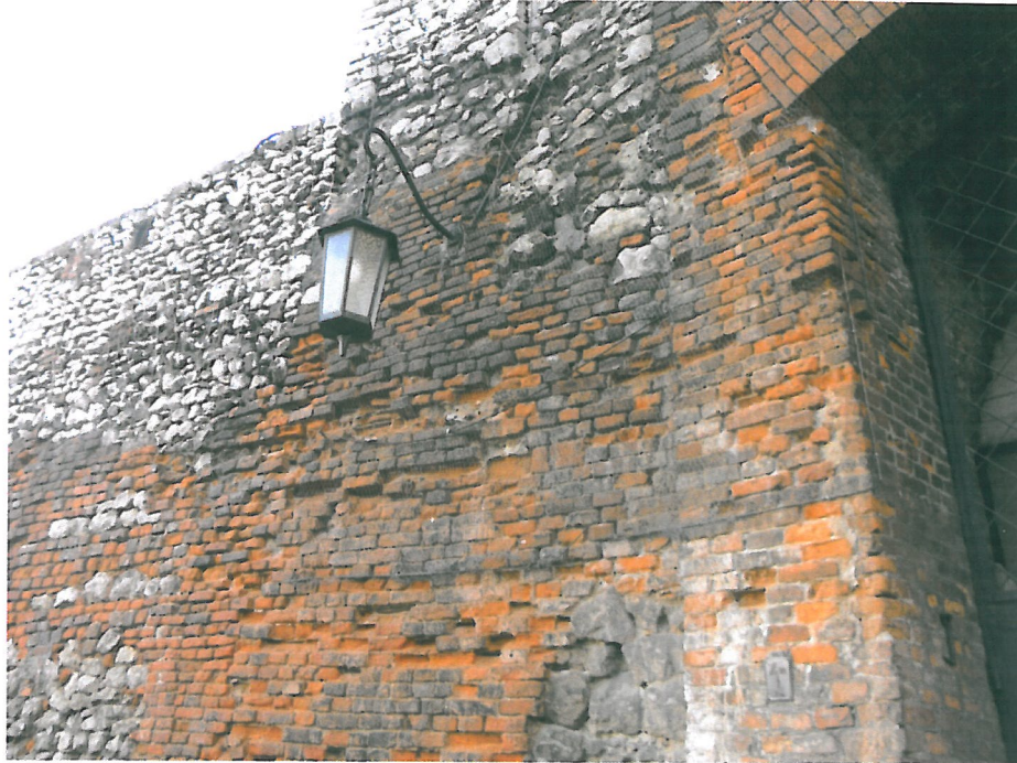
Fot.10 Ubytki elementów murowych – wysypywanie się licowych części cegieł w sąsiedztwie baszty Tęczyńskiej.
