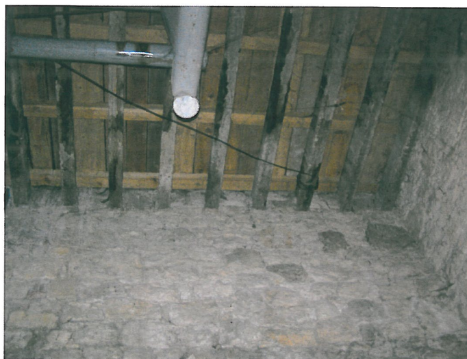
Fot.8 Strop nad piwnicą baszty Szlacheckiej - widoczne przebarwienia i zacieki na belkach żelbetowych.
