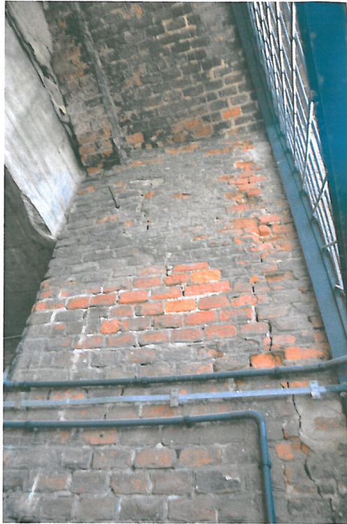
Fot.19 Pęknięcie warstwy licowej muru przy węgarku bramy do baszty Tęczyńskiej.
