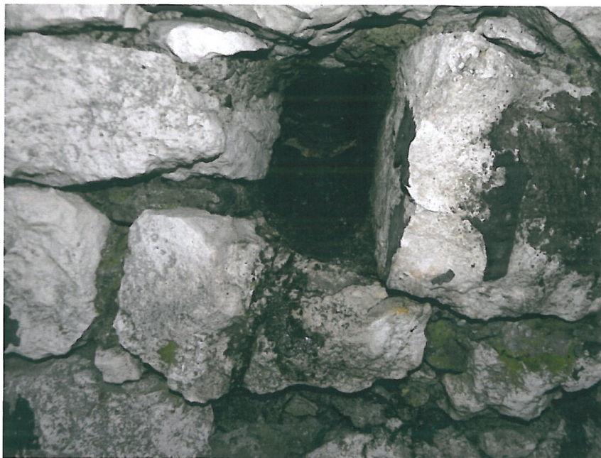
Fot.22 Wyraźnie wilgotny kanał odwadniający – wynika stąd, że odprowadza wodę.
