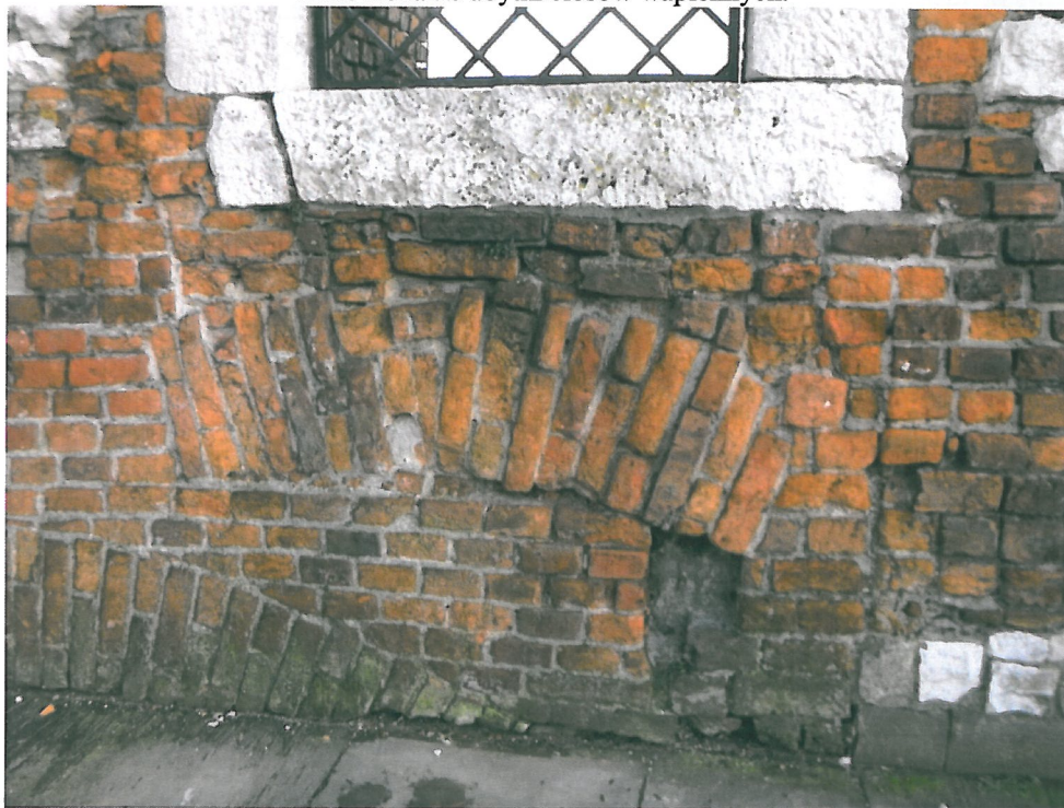
Fot.9 Ilustracja ubytków cegieł ceramicznych na powierzchni pierwotnego wątku muru.
