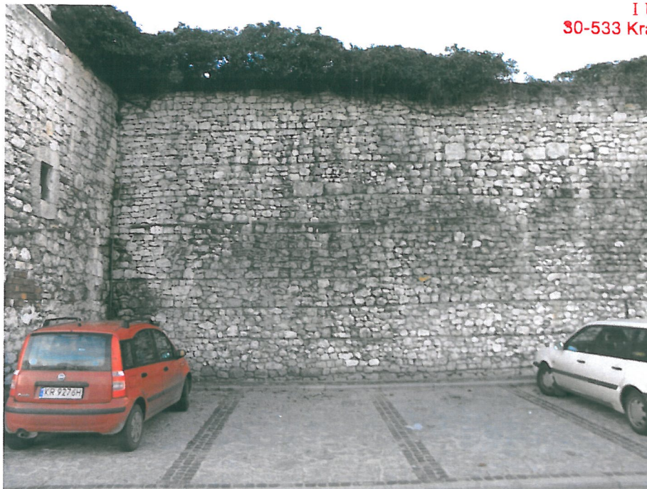
Fot.19 Widoczne strefy przebarwień muru.
