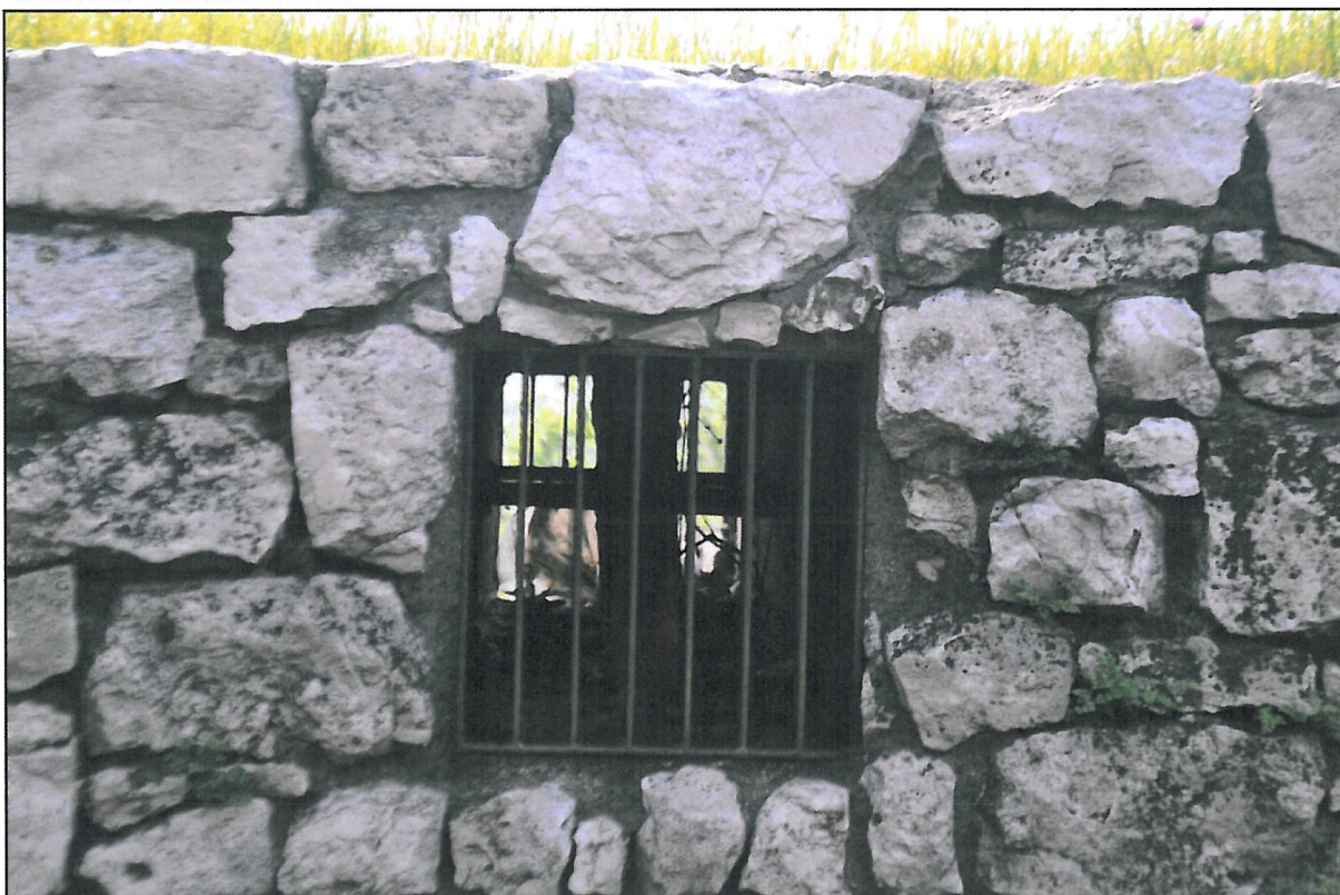
Fot.12 Południowy odcinek wew. muru obwodowego – od strony dziedzińca zewnętrznego. Kratka zabezpieczająca otwory wentylacyjne. Spoinowanie muru rekonstruowanego wgłębnie, w zagłębieniach gnieździ się roślinność. Czerwiec 2016r. M.Wida
