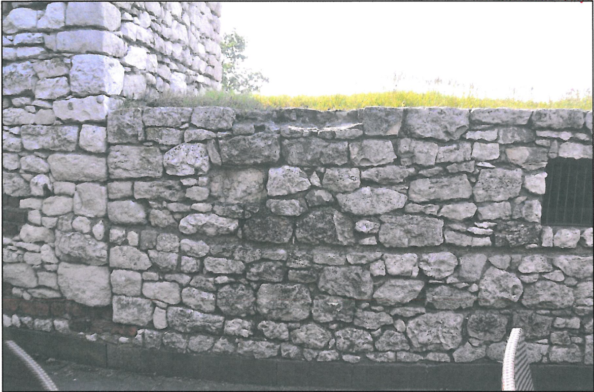
Fot.4 Południowy odcinek wew. muru obwodowego – od strony dziedzińca zewnętrznego. Narożnik Baszty Tęczyńskiej na styku z rekonstruowanym odcinkiem muru (rekonstruowany odcinek porastają byliny). Na powierzchni kamienia warstwa brudu Czerwiec 2016r. M.Wida
