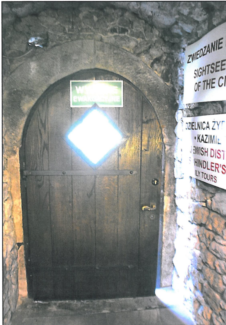
Fot.43 Południowy odcinek wew. muru obwodowego – Wnętrze Baszty Panieńskiej (przewodnicy). Drzwi drewniane od wewnątrz w bardzo dobrym stanie zachowania. Na powierzchni kamiennego portalu warstwa brudu.
