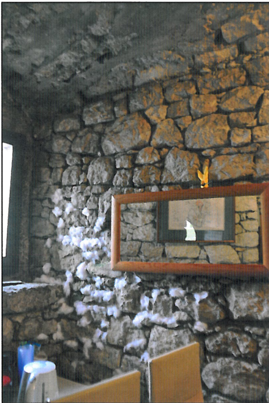
glif okna baszty Panieńskiej, ubytki w spoinowaniu przez które wydostaje się woda zabezpieczone watą
