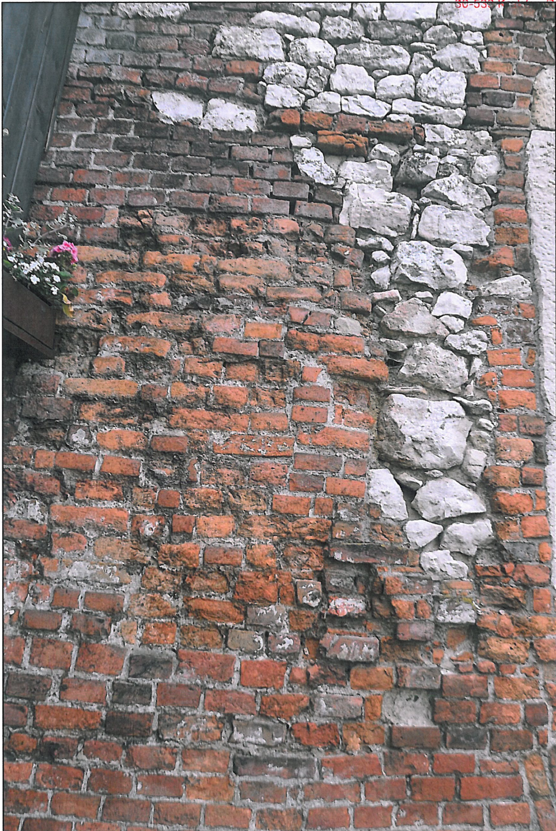
Fot.3 Południowy odcinek wew. muru obwodowego – od strony dziedzińca zewnętrznego. Fragment Baszta Tęczyńskiej. Destrukcja lica ceglanego, ubytki spoinowania Czerwiec 2016r. M.Wida
