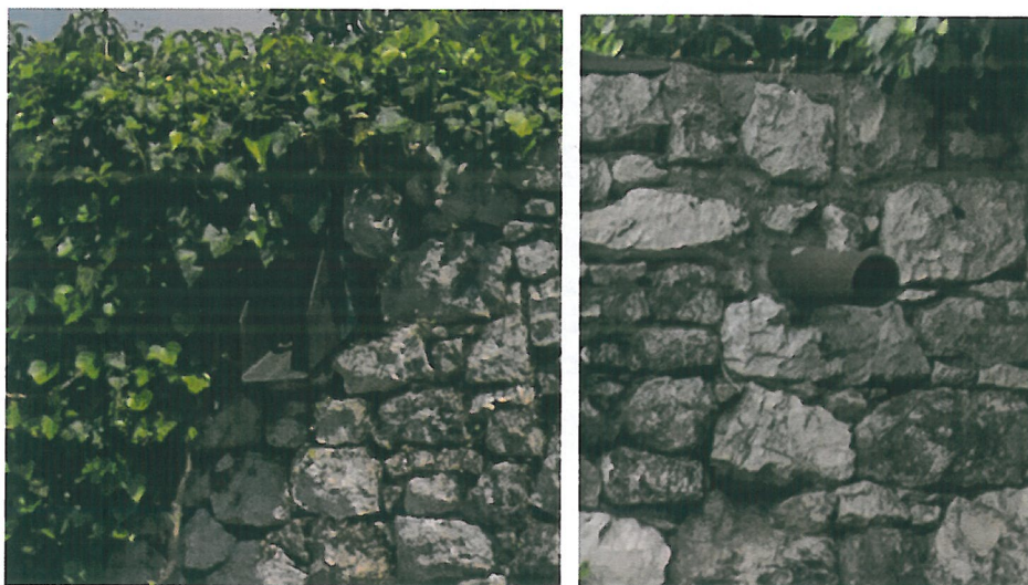
Istniejący system odwodnienia dachu baszty Panieńskiej przeznaczony do usunięcia
