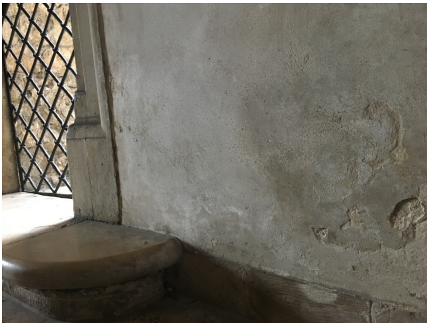
Fot. 3. stan zachowania tynków na ścianie północnej ( część A )
