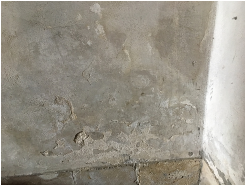
Fot. 2. stan zachowania tynków na ścianie północnej ( część A)
