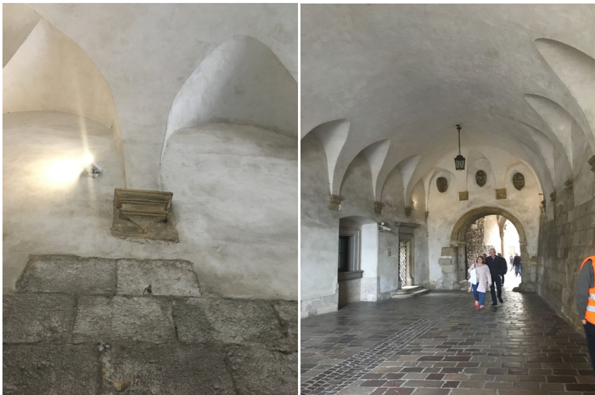
Fot. 6. Widoczne niewielkie ubytki zaprawy przy kamiennym wsporniku sklepiennym ( część A )
